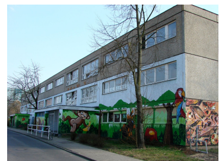
Das 30 Jahre alte Kitagebäude war stark sanierungsbedürftig
